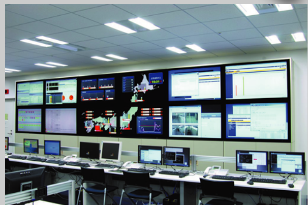
NTT アドバンステクノロジー株式会社 ICT-24 オペレーションセンター
